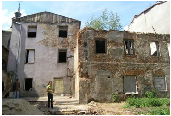
Ryc. 2. Zagrożona rozbiórką kamienica przy ul. Archidiańskiej 1 w Lublinie. Fot. Ze zbiorów WKZ Lublin
