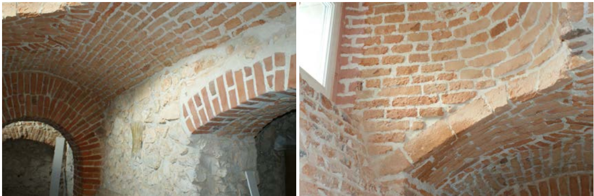
Ryc. 3. Pałac w Cianowicach, widok wnętrza piwnic, stan po modernizacji, 2014 (źródło: dokumentacja Właściciela obiektu, dostęp 2015).
