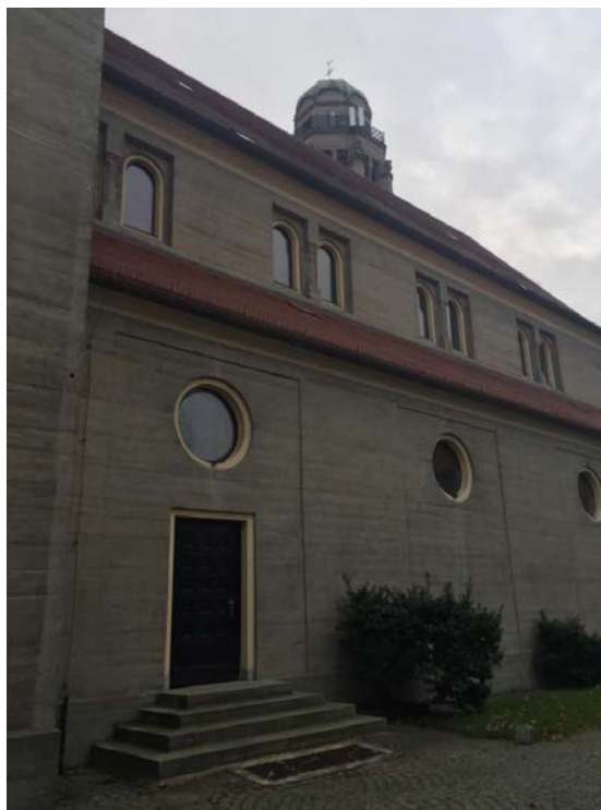
Ryc. 3. Fragment elewacji północnej z widocznymi śladami deskowań.
