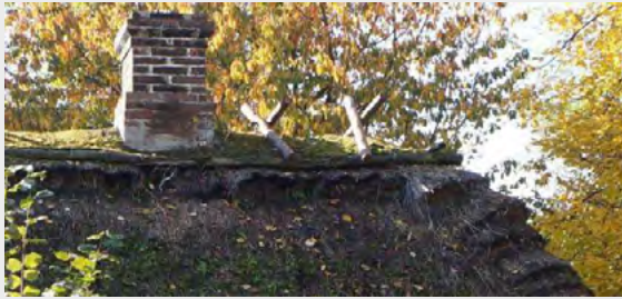
Ryc. 12. Chałupa z Niemiec, połać dachu porażona mchami, uszkodzenia powierzchni licowych komina z cegły ceramicznej [8]
