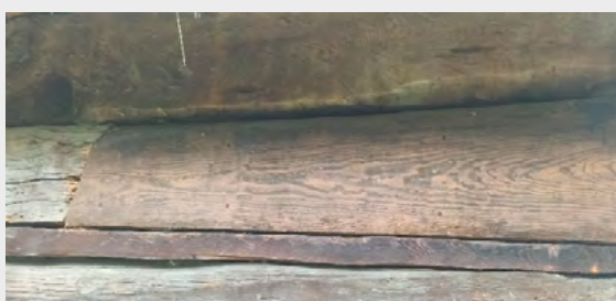
Ryc. 9. Chałupa z Brzezina, miejscowa wymiana skorodowanej belki
