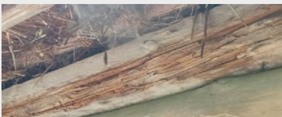
Ryc. 33. Chałupa z Huty Dzierżyńskiej, powiększenie obszaru porażonego przez korozję biologiczną
