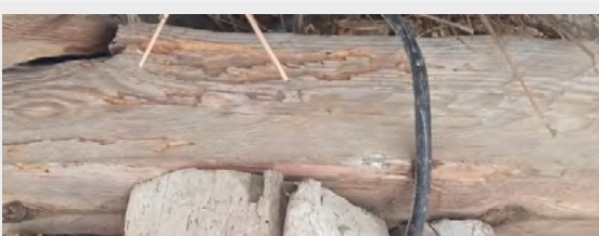
Ryc. 27. Chałupa z Urzędowa, powiększenie powierzchni porażenia przez owady szkodniki techniczne oraz ubytek w materiale słupa
