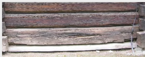
Ryc. 24. Chałupa z Bukowej, spękana i ugięta podwalina [11]
