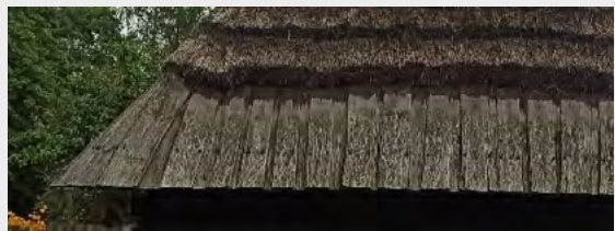
Ryc. 15. Chałupa z Bukowej, oczyszczone deski, miejscowe wykwitły korozji biologicznej pokrycia dachowego
