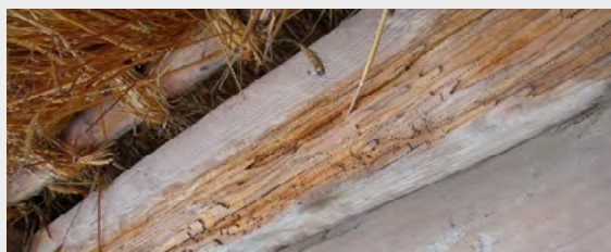
Ryc. 32. Chałupa z Huty Dzierżyńskiej, zniszczenie oczepu spowodowane działalnością owadów i grzybów [1]
