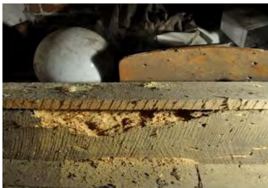
Fot. 25. Aktywne żerowisko z wydrążonymi tunelami spuszcza pospolitego na podwalinie
