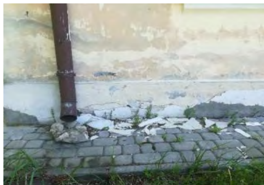
Fot. 32. Skorodowana rura spustowa. Liczne odspojenia struktury tynku na cokole. Niejednorodna powłoka malarska
