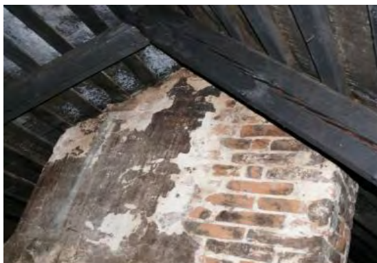
Fot. 27. Szczelina podłużna krokwi, ubytki i spękania tynku pokrywającego powierzchnię komina
