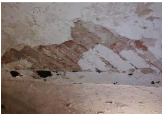
Fot. 30. Skorodowane belki stropu odcinkowego w piwnicy.
