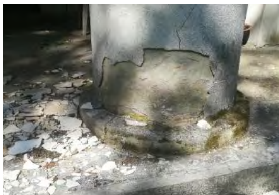
Fot. 31. Odspojenia tynku na kolumnie
