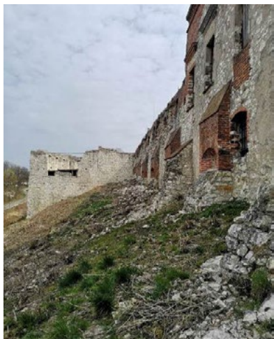
Ryc. 16. Zniszczenia muru północnego. Autor: Katarzyna Drobek
