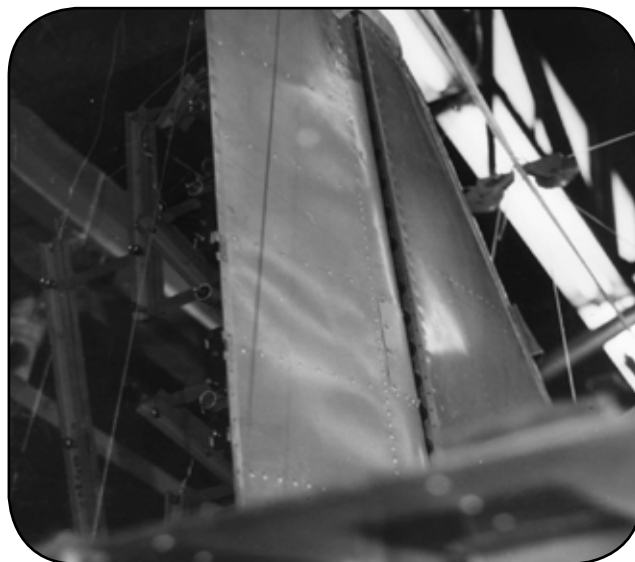
Rys. 12. Pofalowane pokrycie usterzenia kierunku. Fot. Jerzy Mularczyk
